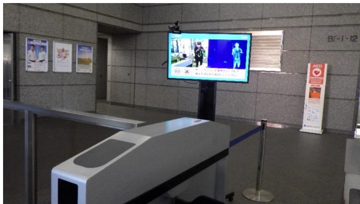
赤外線サーモグラフィ装置(法務ゾーン1階ほか)
